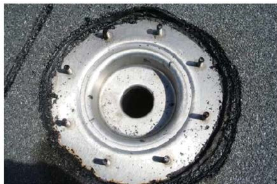
Рисунок 12.3. Водоизоляционный ковер не наклеен на фланец воронки внутреннего водостока
